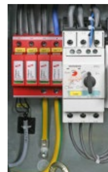
Figuur 12: overspanningsbeveiliging geaard aan chassis van een metalen elektrische kast
